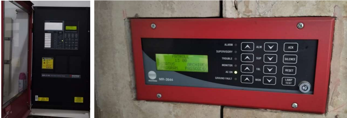
Ilustración 1 Central y repetidor Secutron
