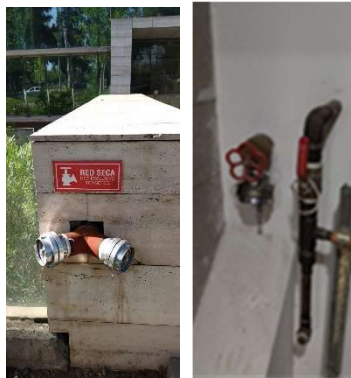
Ilustración 6 Siamesas para bomberos en el exterior del edificio y las conexiones internas
