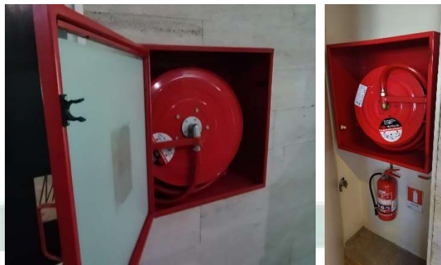
Ilustración 5 Gabinetes de mangueras contra incendios en pisos de oficinas
