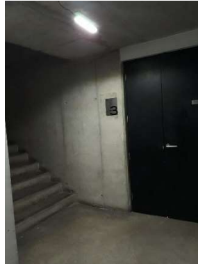
Ilustración 10 Equipos de emergencia en caja escala
