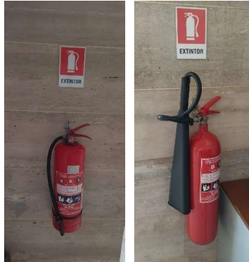
Ilustración 8 Extintores de Co2 y PQS
